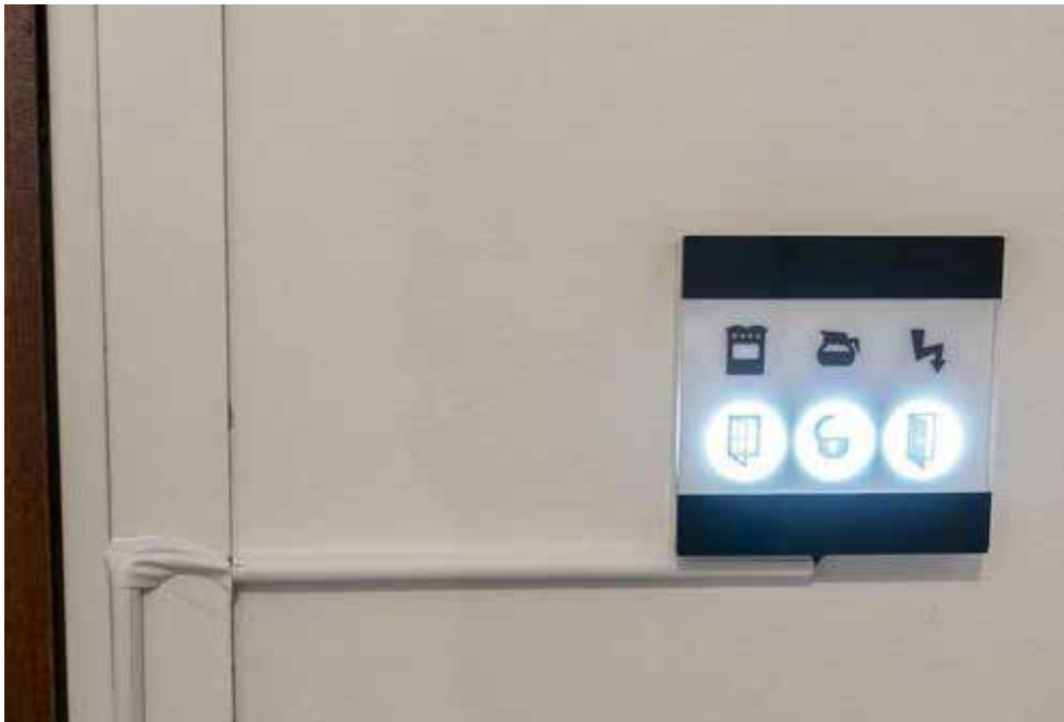
En smart panel vid ytterdörren visar information om t.ex dörren är öppen!
